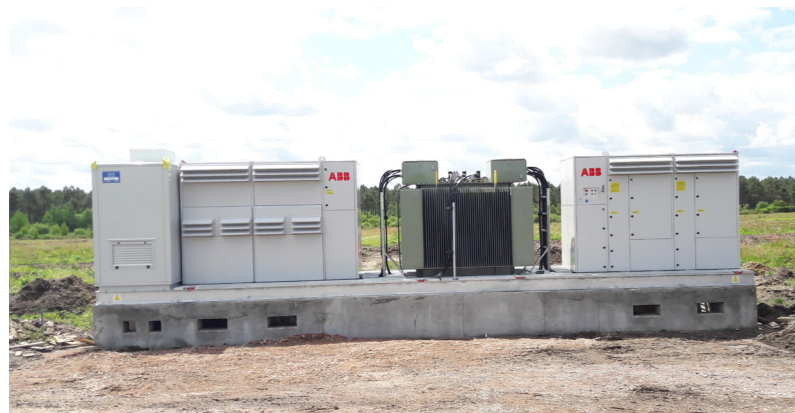
Exemple de poste de transformation «Outdoor»
